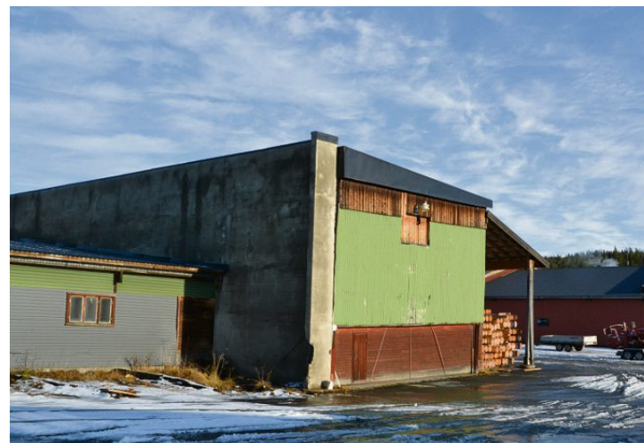
Det aktuelle lagerbygget er i dårlig forfatning og kan virke skjæmmende. Rennebu kommune ønsker derfor å gå i videre dialog med Sande Hus og Hytter. Foto: Jan Inge Flå
